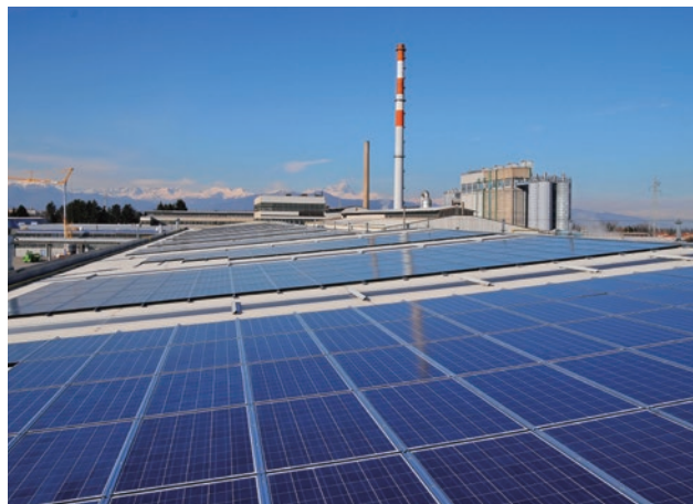
クネオ工場の太陽光パネル
