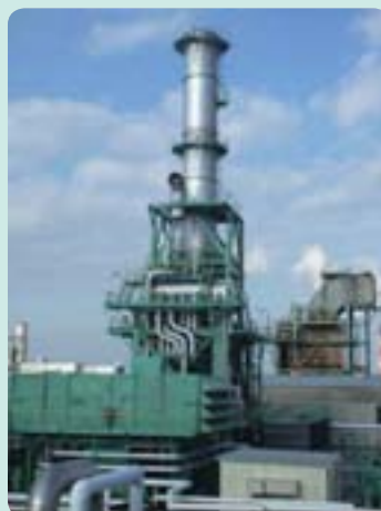
旭硝子千葉工場に新しく導入された、ガスタービン発電設備
