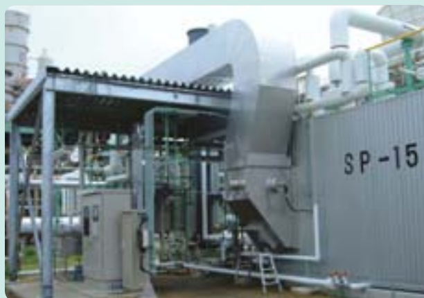
大幅なCO 2 排出削減を実現した水素ボイラー
