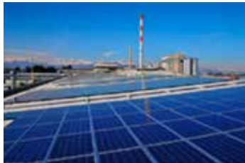
クネオ工場の太陽光パネル
