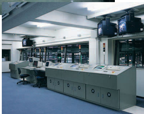
自動化された自動車ガラスの加工ライン設備。稼働の監視は別室の加工ライン監視室で、集中的に行われている
