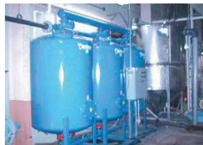
ガラススラッジを除去するサンド・プレッシャーフィルターシステム
