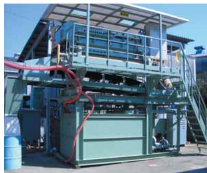
茅ヶ崎工場敷地内に設置した地下水の汲み上げ浄化装置
