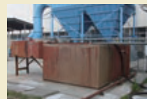
排水再利用のためのタンク
