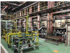
実証試験を行うガラス溶解炉
