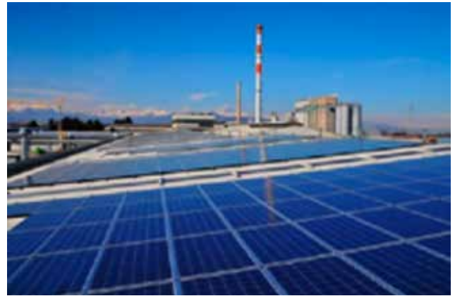
クネオ工場の太陽光パネル
