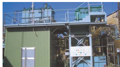
地下水揚水浄化設備(セイミケミカル(株))
