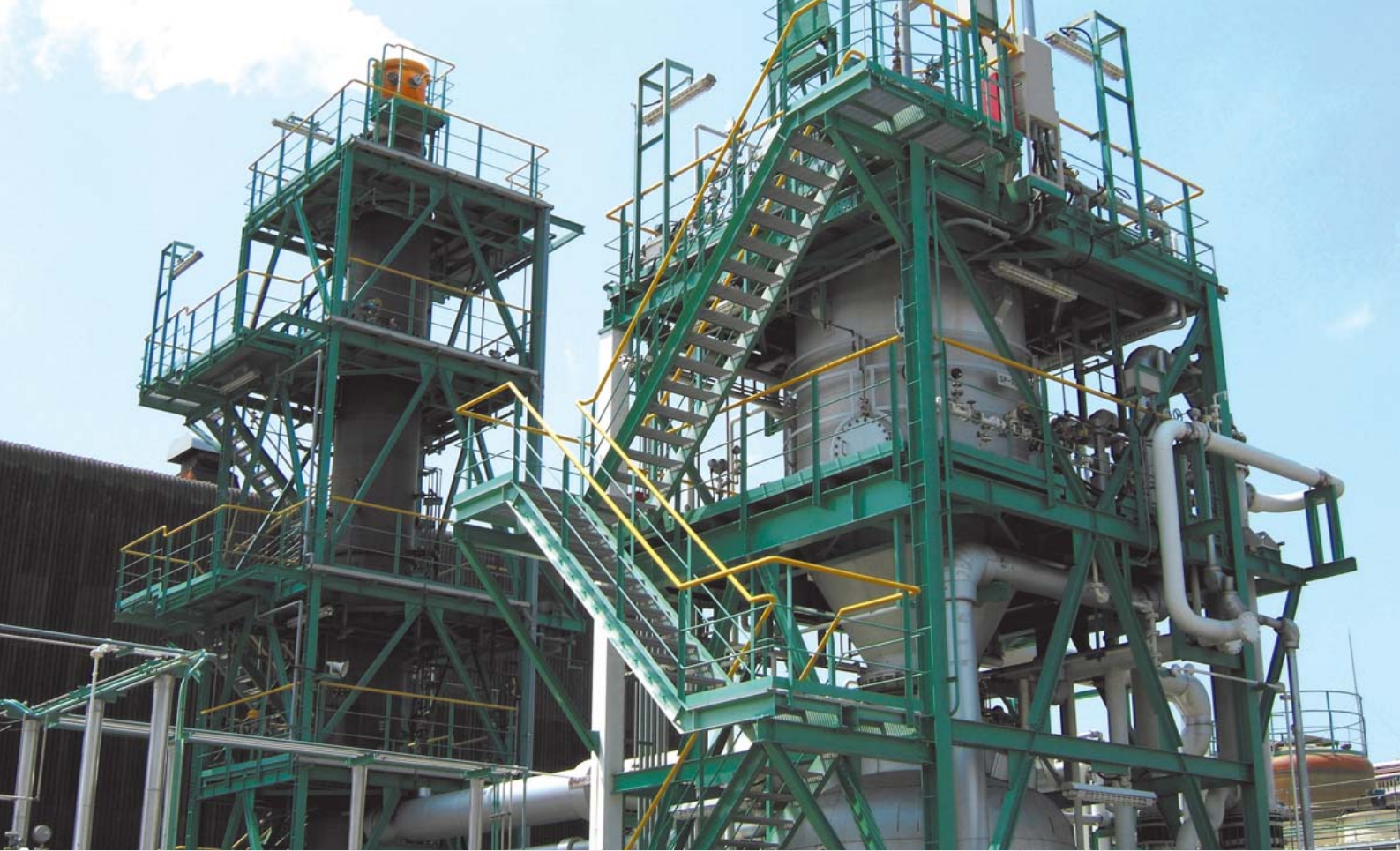
フロン破壊設備(1,000t/年の能力)
