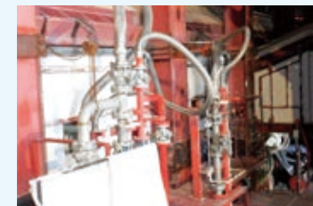
今回実証試験を行ったガラス溶解炉
