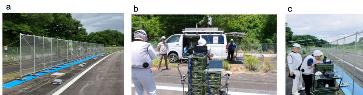
写真：高速道路におけるDASおよび電波反射板を用いた実証実験の様子
