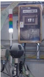
WBGT監視システム
